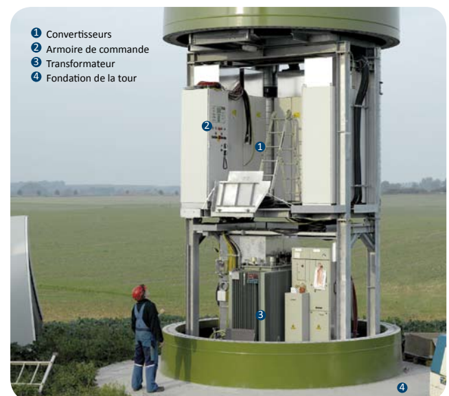
Composants électroniques dans le mât d'une éolienne
